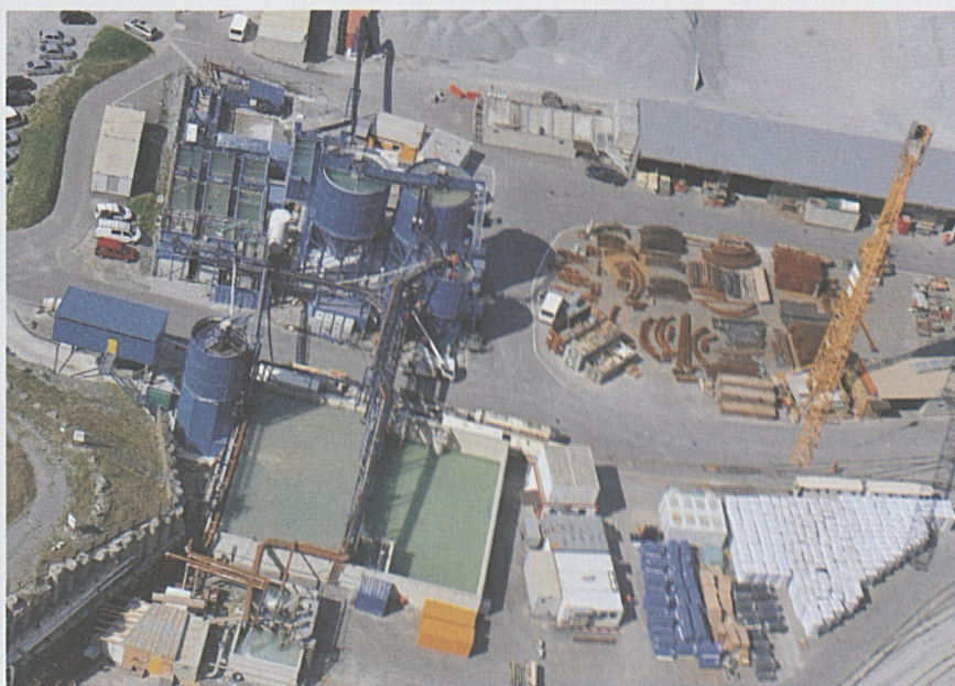
Die Wasserbehandlungsanlage musste aufgrund der grossen Mengen an Bergwasser erweitert werden.
