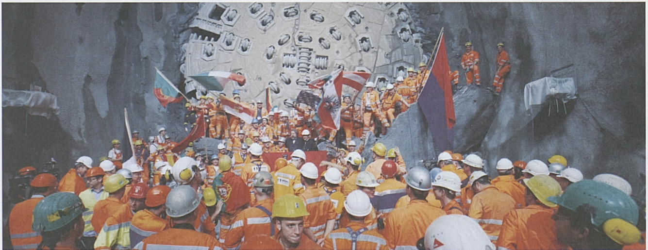
Flaggen aus allen europäischen Ländern: Mineure der ARGE TRANSCO begrüßen nach dem Durchschlag ihre Kollegen der ARGE TAT.
