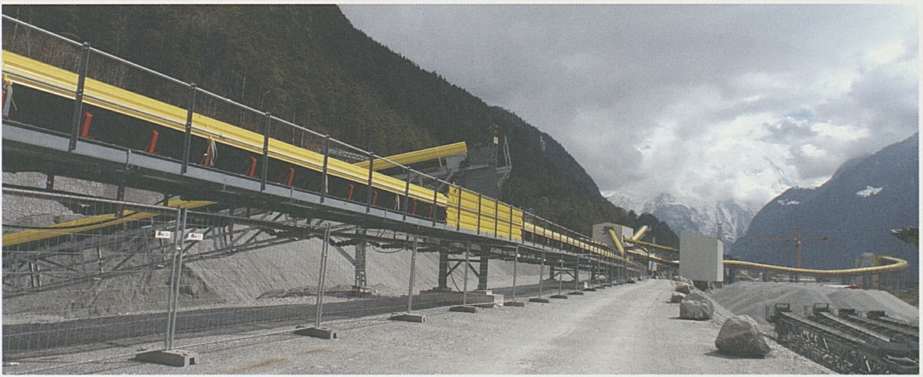
Von der Siebstation (Hintergrund) geht das Ausbruchmaterial per Förderband in die Zwischenlager.
