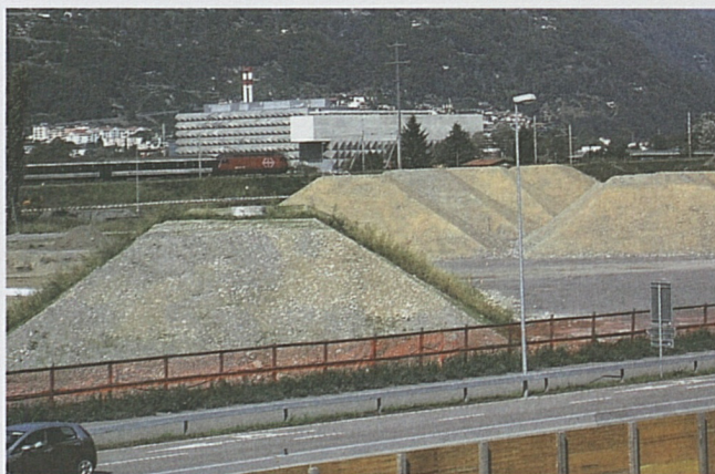
Camorino: rilevati di prearico dei futuri viadotti a nord della strada cantonale.
