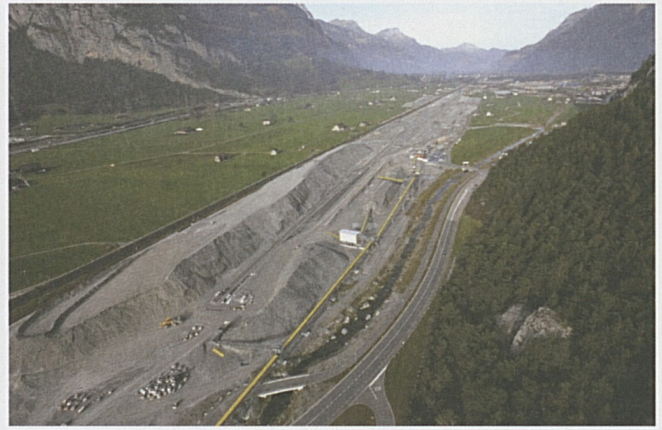
Rynächt: panoramica sul piazzale d'installazione della tecnica ferroviaria. Sotto: Il sottopasso Rynächt sul tracciato a cielo aperto Altdorf/Rynächt.
