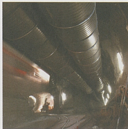
Foto sotto: tubi d'aerazione a Sedrun.
