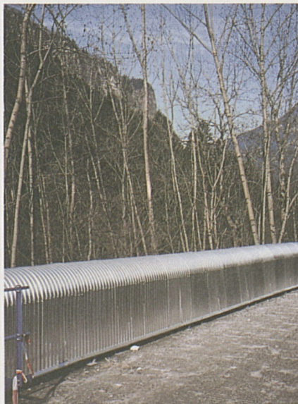
Il nastro è stato completamente rivestito per evitare polvere e rumore.
