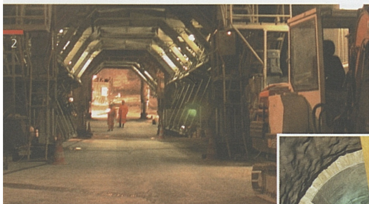
Due fasi dei lavori alla discenderia di Polmengo. Sopra: il cassero ai piedi della discenderia. A destra: il tubo per la ventilazione.
