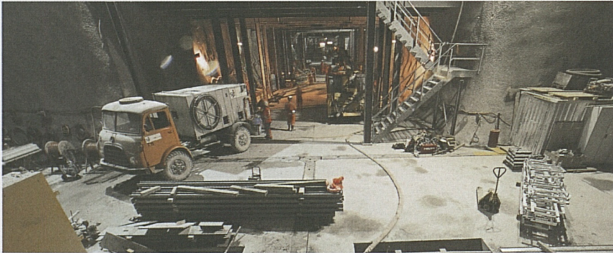
Links: Auch in der Querkaverne 2 am Schachtfuss wird rund um die Uhr gearbeitet.
