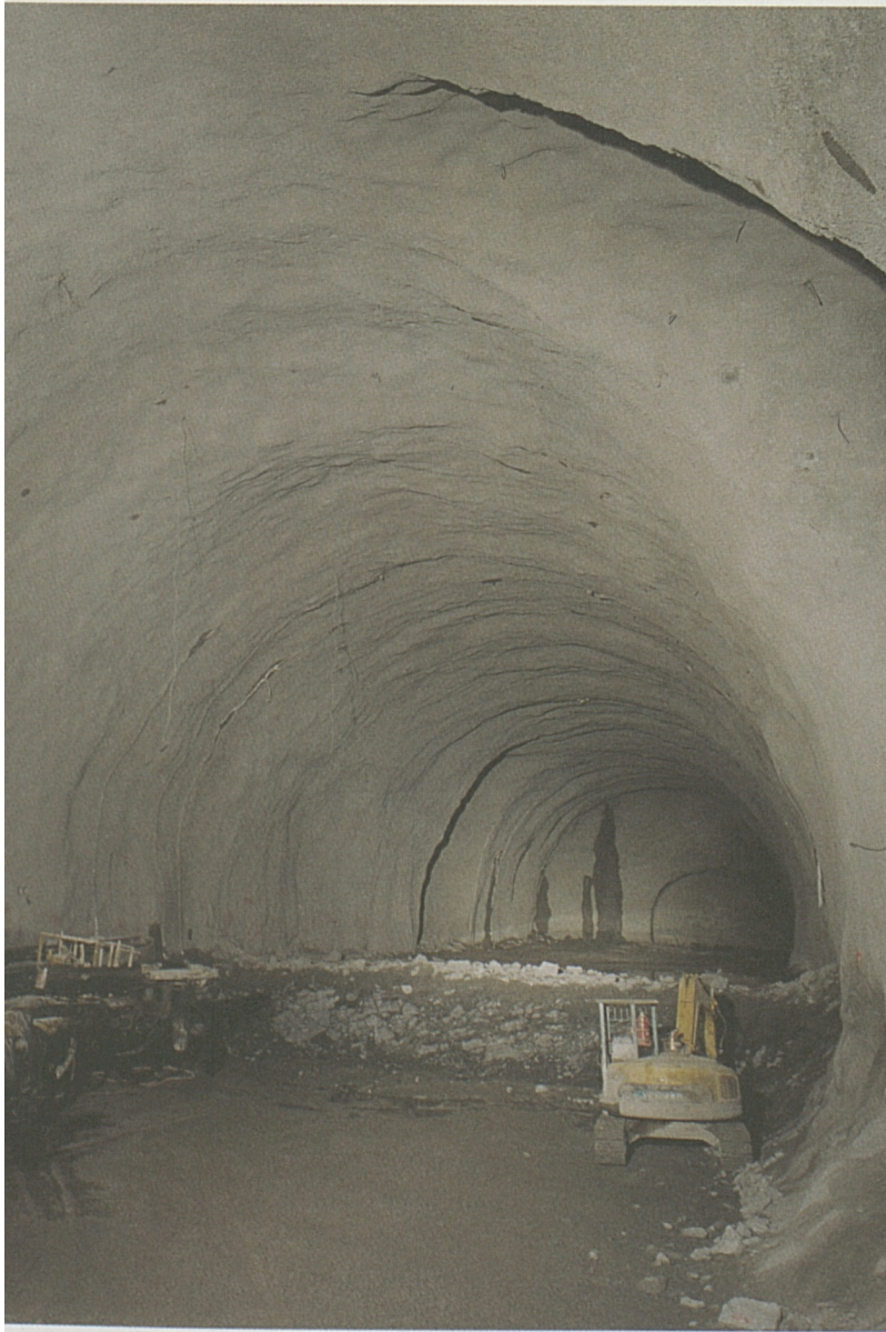
Im August 2000 haben die Ausbrucharbeiten für die riesigen Längs- und Querkavernen begonnen. Noch im Sommer 2001 werden diese Arbeiten abgeschlossen.
