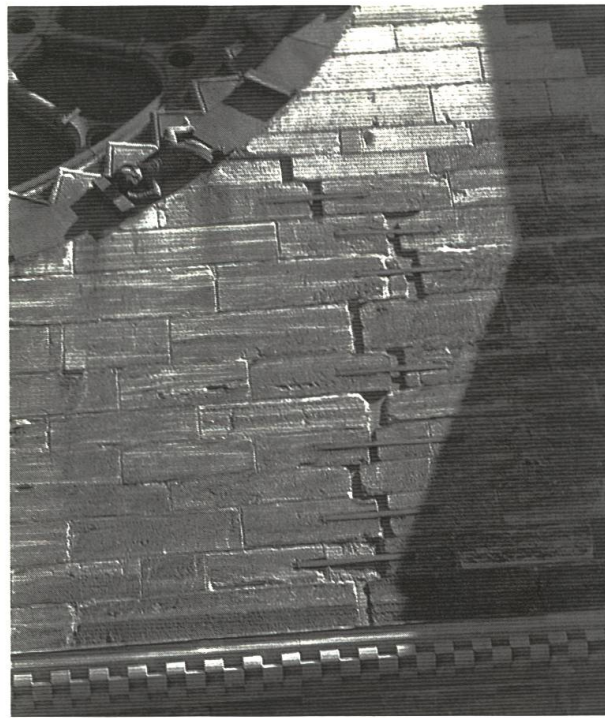
Abb. 16: Basler Münster, nördliches Querschiff. Verklammerte Risse unterhalb des Glücksrades, vermutlich beim Erdbeben entstanden.
