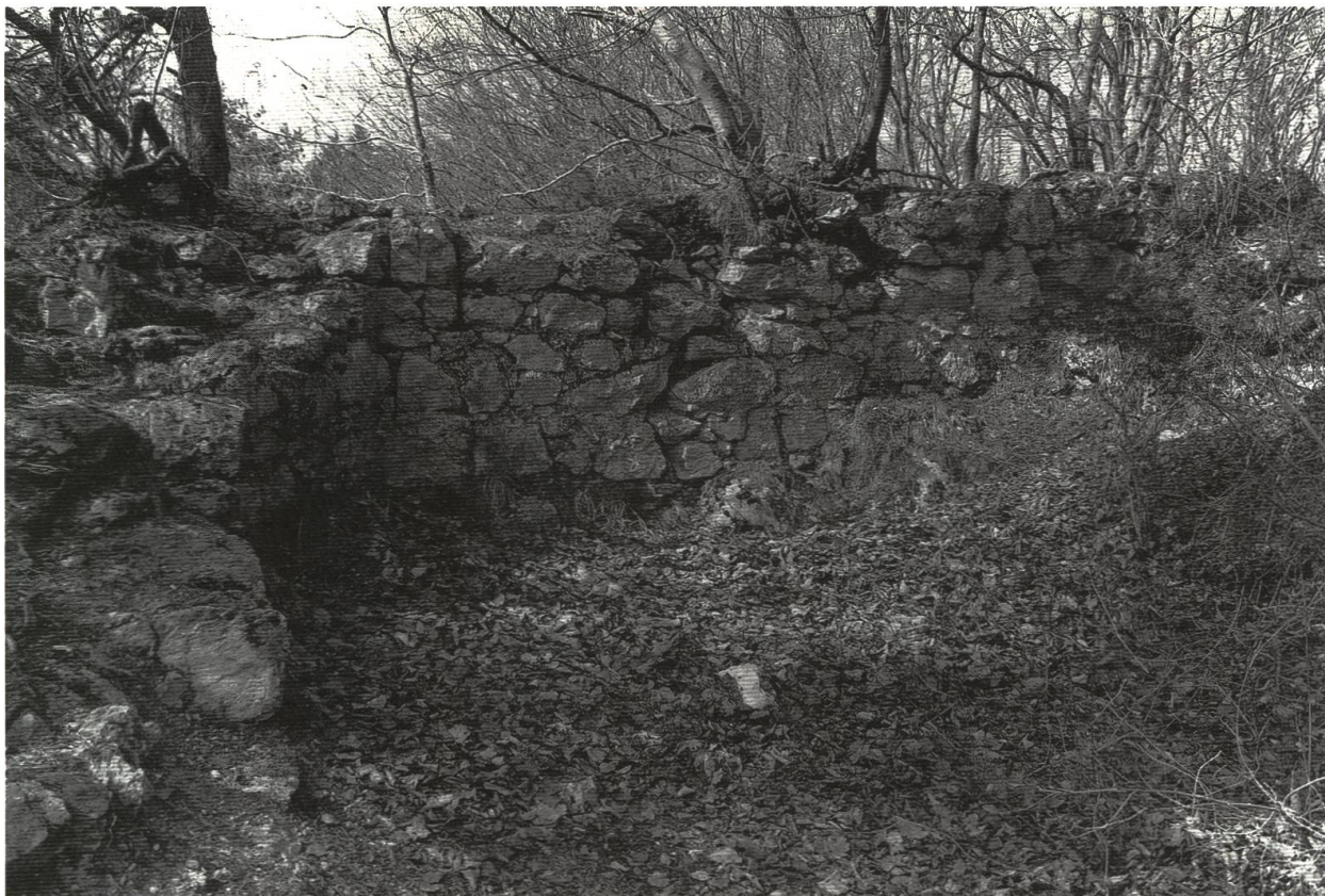
Abb. 23: Burgruine Frohberg (Tschöpperli), Gemeinde Aesch, Haupttrakt, mit Erdbebenschutt gefüllt.
