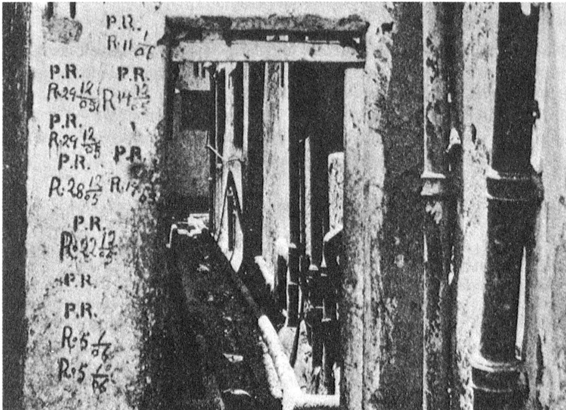
Abb. 7 Abwasserkanal in Bombay. Bei den Untersuchungen durch die Plague Research Commission wurde jeder Fund einer Pestratte an der Kanalwand mit "P.R." (plague rat) vermerkt.
