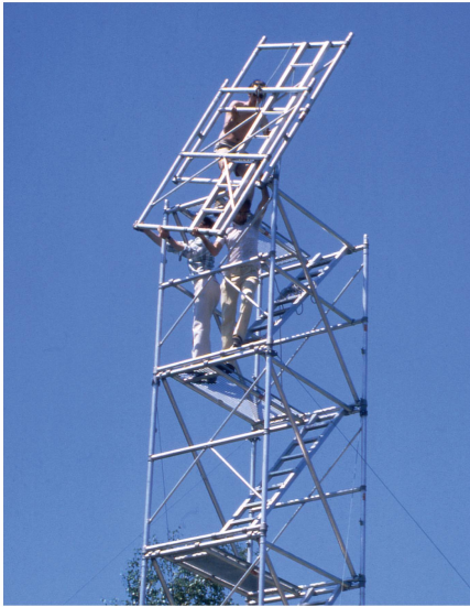
Abb. 10: Aufbau des mobilen Messturms (Höhe bis 24 m) der L+T im Kanton VD (Foto: L+T).
