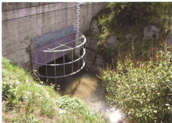
Abb. 2: Mit einem Polder-System wird das mögliche Hochwasser des «Chrouchtalbachs» zurückgehalten. Die Drosselung der Wassermenge erfolgt mittels Schiebern. Ein Grobrechen verhindert das Verstopfen der Schieberöffnung.
