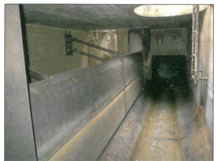
Abb. 2: Hochwasserentlastung in San Nazzaro (Sciarini SA).
