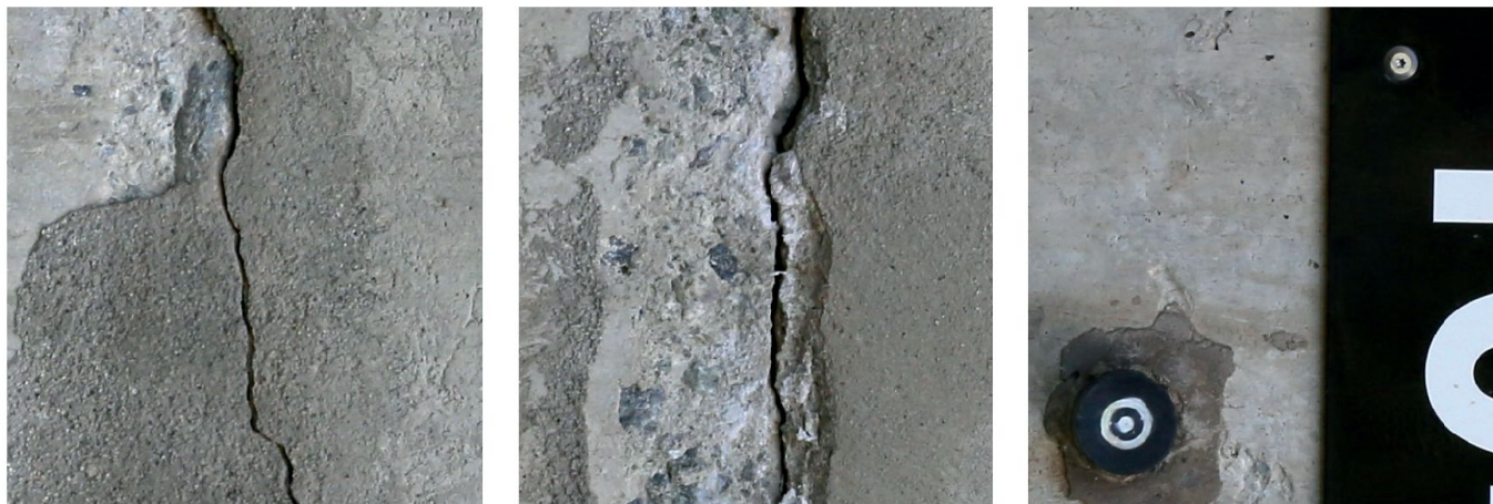
Fig. 5: Détails dans les images à haute résolution de la voûte du barrage.
