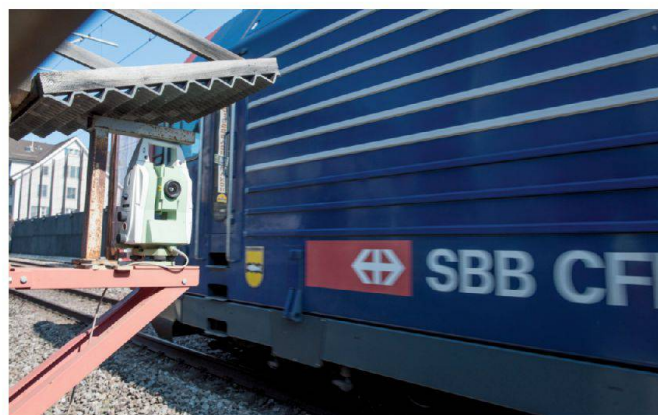
Abb. 2: Ein permanentes Gleismonitoring gewährleistet die notwendige Sicherheit im laufenden Baustellenbetrieb. Kostspielige Sperrungen der Gleise erübrigen sich.
