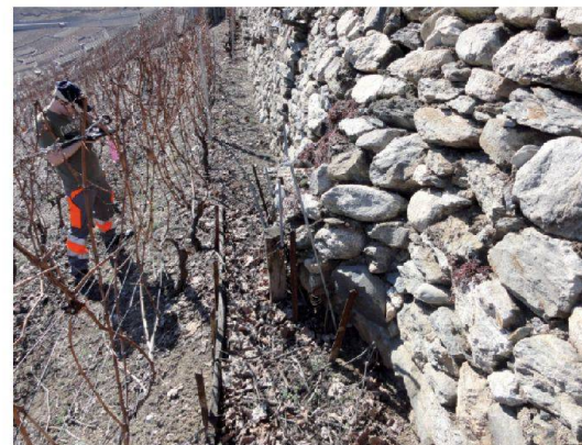
Fig. 1: Relevé d'un dégât présentant un parement bombé.
