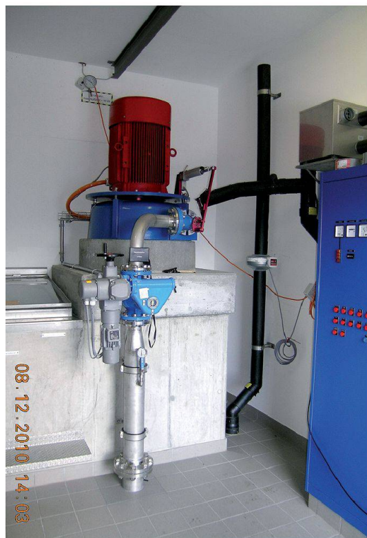
Abb. 2: Pelton-Turbine, Generator und Schaltschrank im Reservoir mit minimalem zusätzlichem Platzbedarf. Fig. 2: Turbine Pelton, générateur et armoire électrique dans le réservoir avec un besoin minimum de place supplémentaire.
