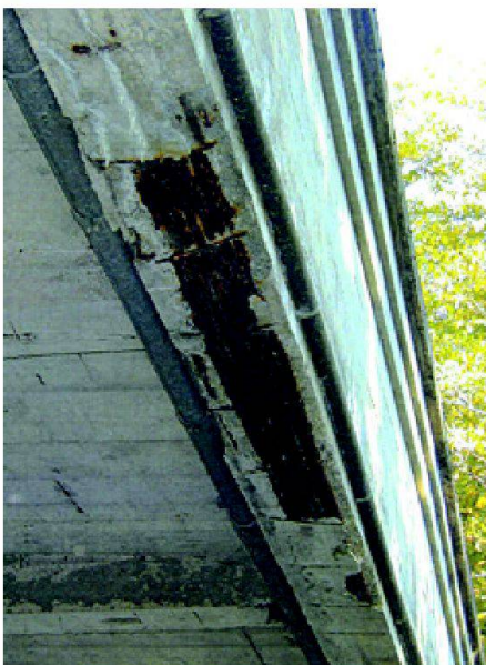
Abb. 4: Freigelegte Längsarmierung der Brückenuntersicht.
