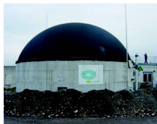
Fig. 5: Installation construite en partenariat avec la ville de Feldkirch (A). Elle est actuellement en cours d'agrandissement pour faire face à la sous-estimation de la production de biogaz par les substrats. La membrane flexible en forme de cloche située sur le silo béton renferme le biogaz.
