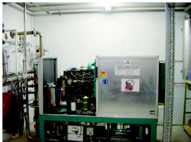
Fig. 4: Le couplage chaleur-force est constitué d'un moteur à gaz relié à un générateur. Il transforme l'énergie contenue dans le biogaz en courant électrique et en chaleur.
