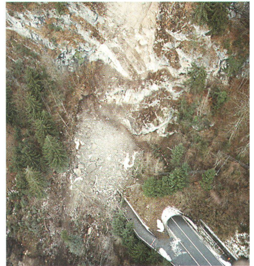
Abb. 2: Zerstörung des Tunnelportals durch einen Felssturz bei Iseltwald.
