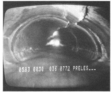
Fig. 5 Contrôle par TV, tuyau ovalisé (photo Krähenmann) (mai 1983, Ø 30, photo 36, à 77,2 m de la chambre)
