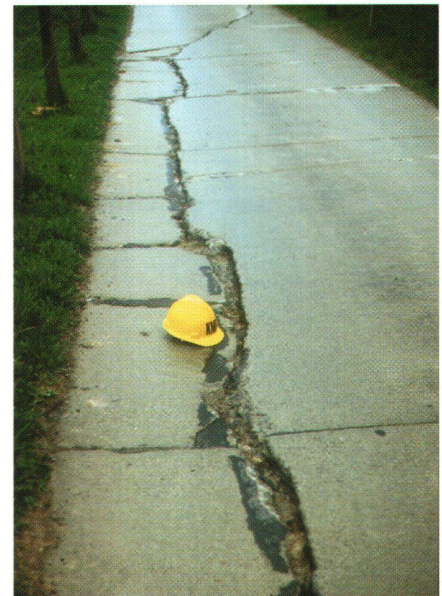
Abb. 4: Betonweg Stägmatte bei Brienz. Die Werkserhaltung im Wegebau gewinnt stark an Bedeutung, die Abteilung Strukturverbesserungen ist beauftragt, den Unterhalt zu überwachen.
