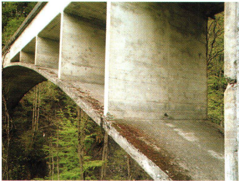
Abb. 5: Maillartbrücke über den Traubach, Gemeinde Habkern. Wie rettet man ein Baudenkmal? Kostengünstige Ideen sind gesucht.
