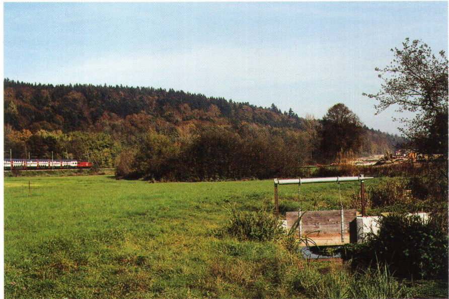
Abb. 3: Grossbaustelle Bahn 2000, Brunnmatten, Gemeinde Roggwil: links die heutige Bahnlinie, deren Damm als Trockenstandort bestehen bleibt, rechts hinten das neue Trassee im Bau. In den umliegenden Gebieten müssen die Anliegen der Landwirtschaft samt Erschliessung und jene des Natur-, des Landschafts- und des Gewässerschutzes (Gewässerraum, Grundwasser, Wässermatten) mit berücksichtigt werden (2001).
