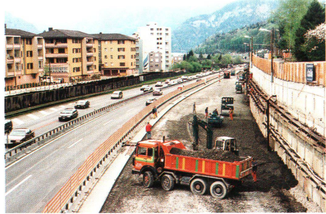
Abb. 6: Verkehrsprovisorien: Vorbereitung von provisorischen Fahrspuren.
