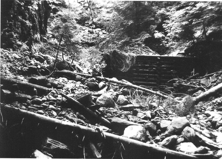
Abb. 1: Mangelnder Gewässerunterhalt; zerstörte Verbauungen erhöhen das Gefahrenpotential.
