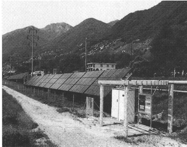
Abb. 4: Photovoltaik-Netzverbundanlage entlang der SBB-Linie Bellinzona-Locarno.
