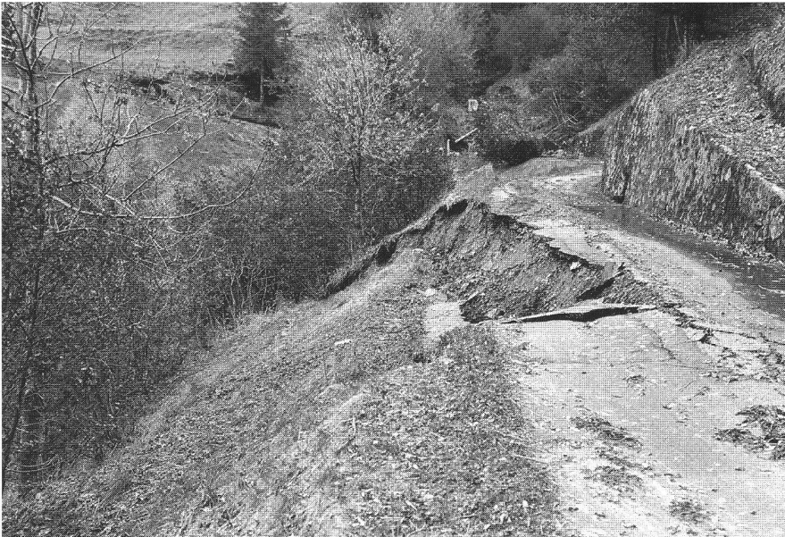
Abb. 1: Unwetterschäden 93, Campo Blenio (TI), Güterweg bei Pianchera. Die Unwetterschäden in den Kantonen TI und VS wurden 1994 mit Hilfe von Sonderkrediten grösstenteils behoben. (Photo: M. Giamboni, studio tecn. d'arch. Imperatori e Giamboni SA, 6715 Dongio.)
