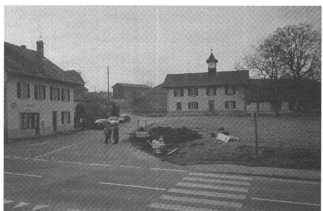
Vue du chantier d'aménagement de la place publique près de la poste (à gauche) et du collège (au fond).
