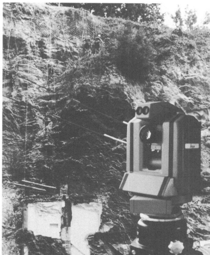
Abb. 2: Während die «Felsputzer» im gefährdeten Hang über der Kantonsstrasse ihrer gefährlichen Arbeit nachgehen, überwacht der motorisierte Präzisionstheodolit Wild TM3000 als Teil des Leica Systems APSWin aus sicherer Distanz automatisch zahlreiche Punkte links und rechts des Abbruchgebietes. Bis jetzt haben sich keine anderen Teile des Hanges mehr bewegt.
