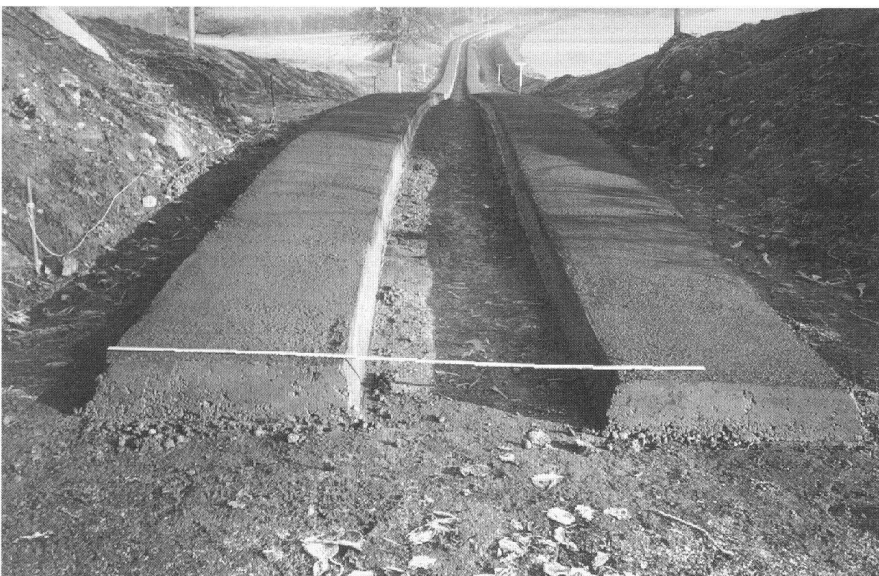
Abb. 3: Ortsbetonspuren maschinell eingebaut. Gesamtmelioration Lieli (LU). Fig. 3: Bandes de roulement en béton coulé sur place posées à la machine. Amélioration intégrale de Lieli (LU).
