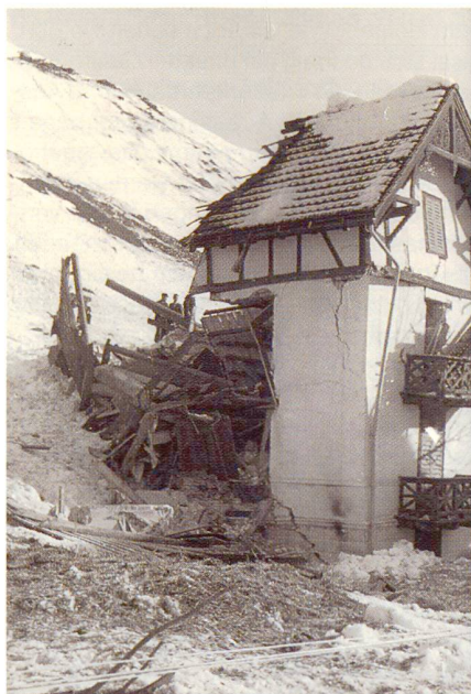
Abb. 8: 70-jähriges Gebäude von einer Jahrhundertlawine erfasst. Die Bewohner hielten sich beim Lawenniedergang im stehengebliebenen Hausteil auf! (Disentis, 10. 2. 1984. Foto SLF).
