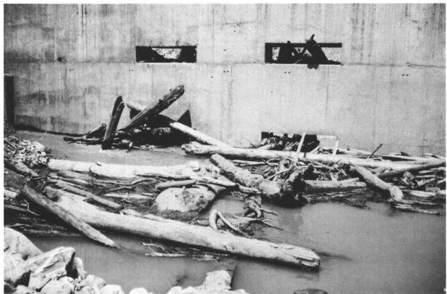
Abb.4 Das Treibholz verstopft die Sperrenöffnungen und führt zu unerwünschtem und nicht vorhersehbarem Rückstau.
