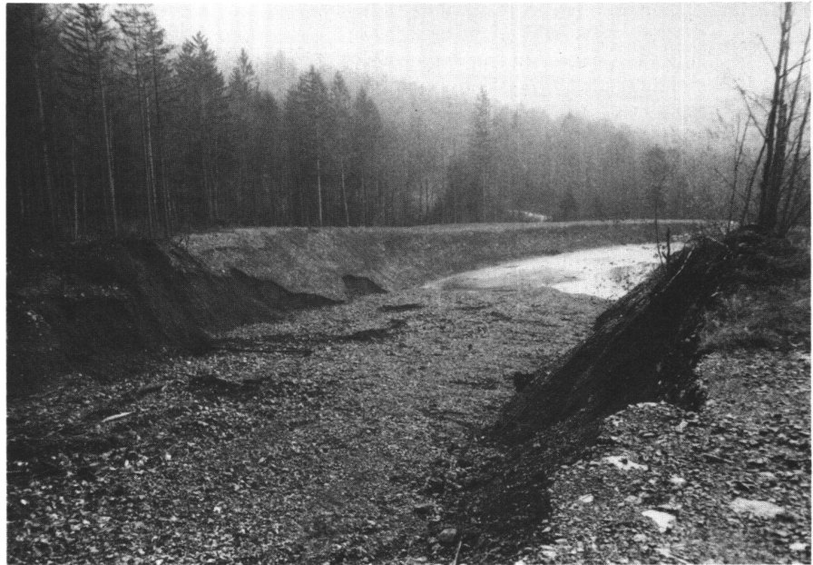
Abb. 8 Einlauf in den Ablagerungsplatz des Eistlenbaches bei Hofstetten (BE) 1981: Durch Seitenerosion sind Einlauf, Bachufer und Umfassungsdämme schwer beschädigt worden. Ursache: Mangelnder Erosionsschutz. Blickrichtung vom rechten Bachufer ins Becken hinunter.
