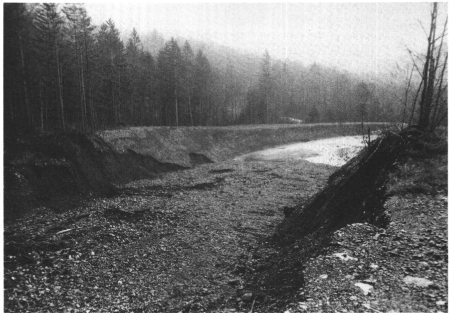
Abb. 8 Einlauf in den Ablagerungsplatz des Eistlenbaches bei Hofstetten (BE) 1981: Durch Seitenerosion sind Einlauf, Bachufer und Umfassungsdämme schwer beschädigt worden. Ursache: Mangelnder Erosionsschutz. Blickrichtung vom rechten Bachufer ins Becken hinunter.
