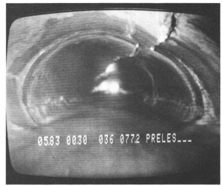
Fig. 5 Contrôle par TV, tuyau ovalisé (photo Krähenmann) (mai 1983, Ø 30, photo 36, à 77,2 m de la chambre)
