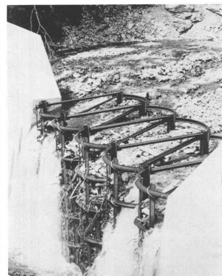
Abb. 5 Immer wieder sind in Österreich neue Sperrertypen entwickelt worden. Das Bild zeigt eine «Reihen-Korb-Sperre» im Dürnbach (Oberpinzgau, Salzburg). Sie ist deformierbar und vermag deshalb Bodenbewegungen und Seitendrucke zu verkräften.
