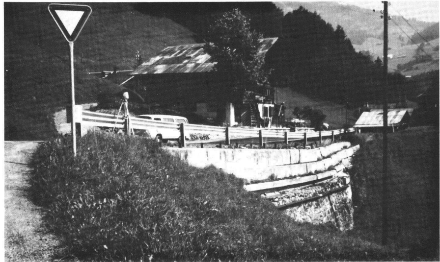
Fig. 2 Mur de soutènement enjambant la limite Est du glissement à la hauteur de Cergnat.
