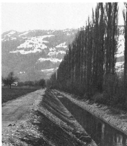
Abb. 2. Der vertiefte und verbreiterte Saarkanal. Kiessohle und Natursteinpflasterung unter Schonung des linksufrigen Pappelbestandes. Neuer Parallelweg. Rechts im Bild erkennt man noch die alte Pflasterung mit kleinen Steinen und damit die Tiefe des alten Kanals. Zustand 1970
