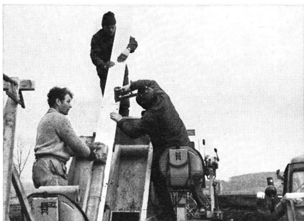
Abb. 5 «Hoes Gigant». Einsatz im Torf, Grabentiefe ca. 1,2 m (Wechselagen mit Sand und Seekreide) Tonrohre (4kantige Form) \varnothing 80 mm auf Holzbrettunterlage. Die Bretter werden laufend zusammengenagelt. Bei runden Rohren werden Bretter mit Randleisten verwendet (siehe Abb. 11).
