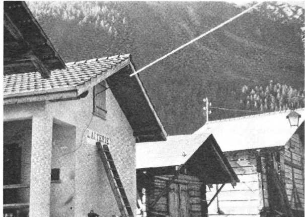
Abb. 10 Die Milchleitung, am Stahlkabel aufgehängt, wird zwischen den Häusern hindurch oberirdisch in die Käserei von Grimentz geführt. Die Briden, mit welchen die Leitung am Stahlkabel befestigt wurde, sind sehr gut sichtbar. Da es sich hier um eine Sommerleitung handelt, erübrigt sich eine Heizung, dagegen würde die Leitung heute vor der Erwärmung durch die Sonne mit einer Isolation geschützt
