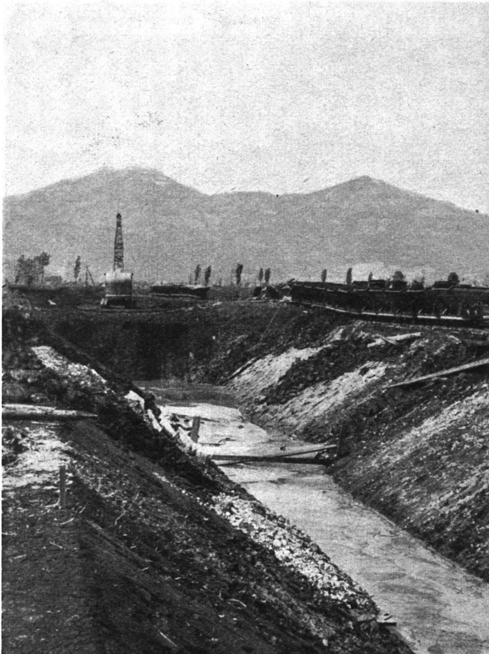
Mittlerer Seegraben, Grundwasser-Aufstoß mit Triebssand Abbildung 3
