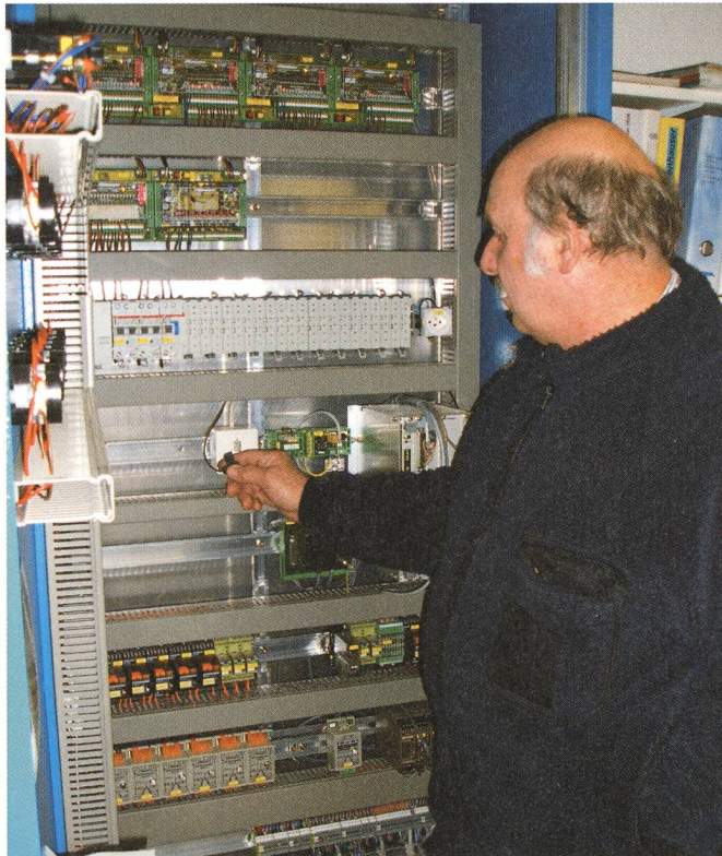
Der Steuerungs- kasten des heutigen Wasserleitungs- systems.
