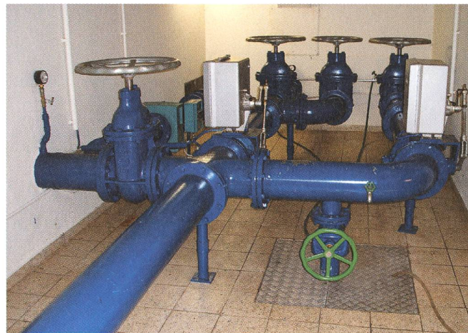
Im Rohrkeller «Neumatt»: zentrale Wasser- verteilung in die Reservoirs und Einspeisung ins Leitungsnetz.
