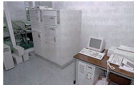
Herz des Systems: Computeranlage
