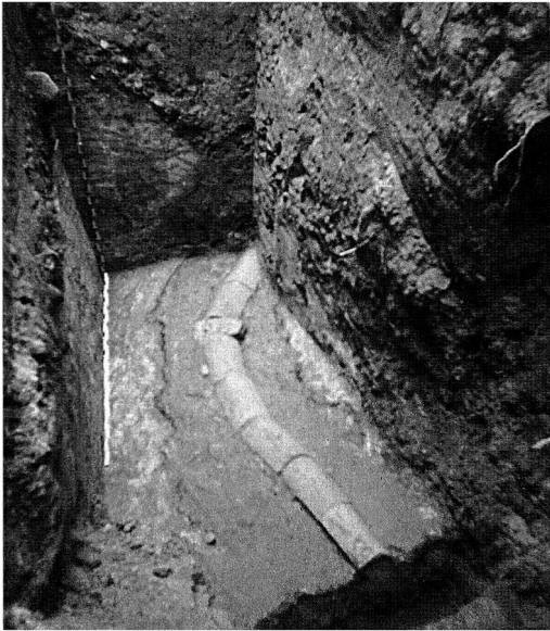
Bild 11: Drover-Berg-Tunnel bei Düren (Deutschland). Die Wasserleitung knickt aus dem Hangverlauf in den Tunnel ab. (Foto: Klaus Grewe)
