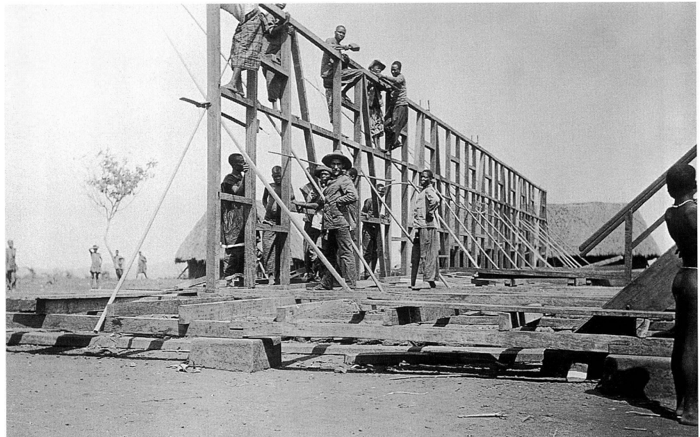
Abb. 5 (Sig. E-30.28.013) Copyright: Archiv der Basler Mission Bauten in der Hauptstadt eines afrikanischen Königs: Missionsbaumeister Eugen Schwarz leitet die Fachwerkkonstruktion des Missionshauses in der Hauptstadt von König Njoya. Der Vergleich mit Abb. 4 ist wichtig. Im Grunde genommen ähneln sich die zwei Bautechniken. Für den Missionsbau mussten zusätzlich zur einheimischen Technik Balken gesägt und die Geometrie und Technik des Zusammenfügens erlernt werden. Keine von den beiden bedeutet; eine grosse neue Abhängigkeit vom Westen. Einmal gelernt, konnten beide Innovationen mit minimalen fremden «Inputs» von afrikanischen Handwerkern eingesetzt werden.
