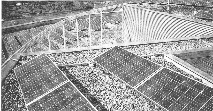
...führt zum Einstieg in die Energiewende: Oben Mini-BHKW, unten Solaranlage.
