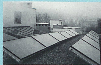
Die Solaranlage deckt 30% des Wärmebedarfs für Wasser.
