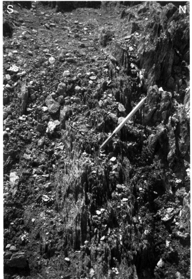
Fig. 6. Detailansicht der Störzone Nr. 20 (nach Frei 1999, westlich des geodätischen Messpunktes M2). Innerhalb des verschieferten Gesteinsmaterials in der Bildmitte treten feinste Bänder von kohäsionslosem "Gesteinsmehl" auf.
