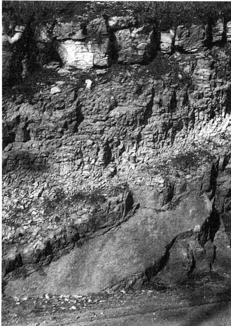
Fig. 25. Vorbourgkalke; Mittlere Partie mit eckig zerfallenden Bänken. Unten Omissionsfläche, darüber Mergelfuge. Côte du Frêne.
