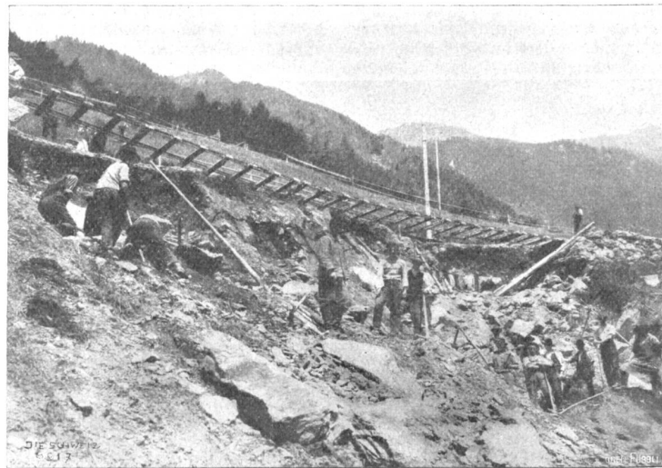
Sernftalstrasse und Bahnlinie durch Hochwasser zerstört. Phot. Schönwetter-Elmer, Glarus.
